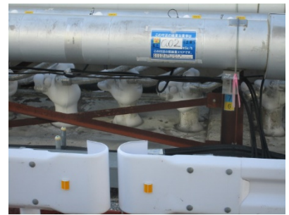
陸側凍土遮水壁設備
